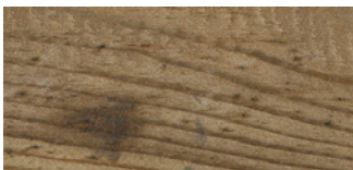
Stockflecken und leichter Schimmelbefall
