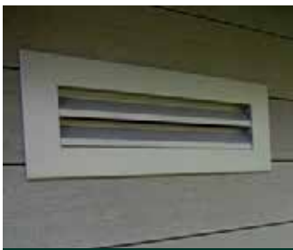
2 Aluminium Lüftungselemente in der Seitenwand
