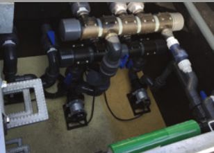
2 Pumpen, Einstiegshilfen, Secure 1- 2.0 und PHOSPAT 1 - 2.0
