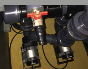
Pumpen und Probenentnahmehahn
