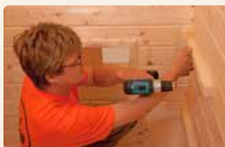
fachgerechter Aufbau (ohne erforderliches Zubehör und ohne Elektroinstallation*)
