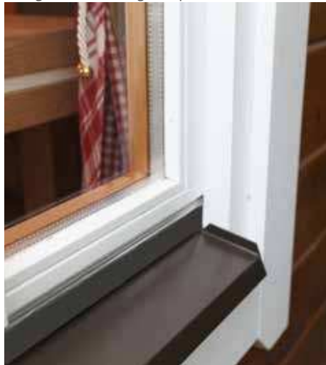
↑ Aluminium-Abtropfkante an den Fenstern
