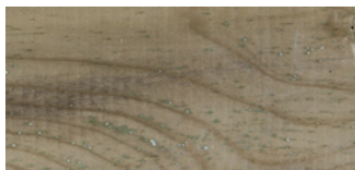
Rauhe Stellen auf der Holzoberfläche
