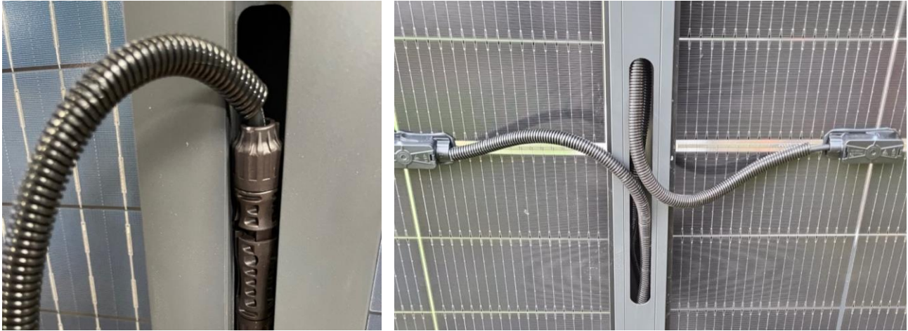
Abb.: Kabelschutz (Wellrohr) und Öffnung im Aluminiumpfosten/ H-Rahmen zwecks verdeckter Unterbringung von überschüssigem Kabelmaterial
