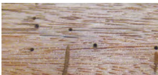
„Pinholes“ bei überseeischen Harthölzern
